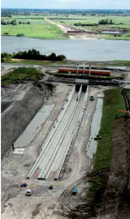
Drontermeer, 7 september 2009. De Drontermeertunnel in aanbouw, duidelijk zichtbaar zijn de kanteldijken aan de beide zijanten. (Foto: ProRail).
